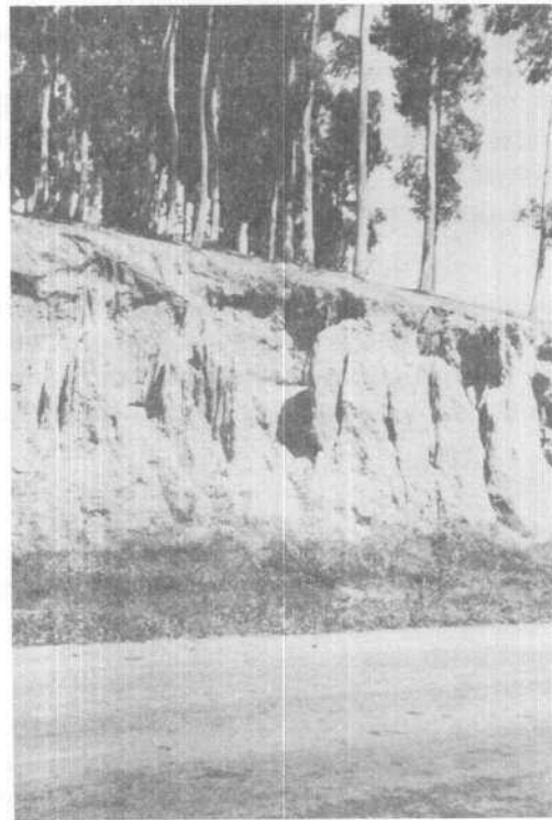
Foto 4. Acarcavamiento en II_1^1 (Palos de la Frontera)
