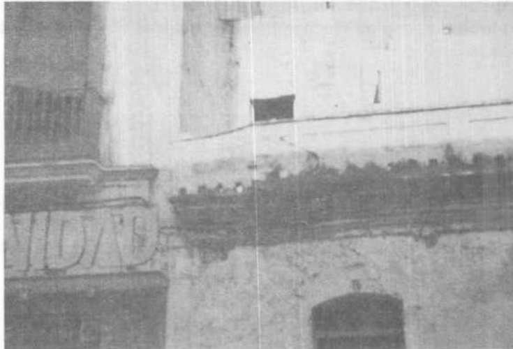
Foto 12: Casa baja cimentada en IV 5 , agrietada por la influencia de una edificación más alta
